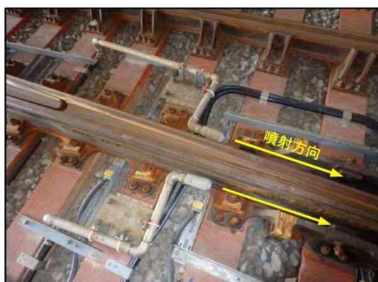
ポイント部の圧縮空気式除雪装置
