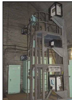
列車火災検知装置(青函トンネル内)
