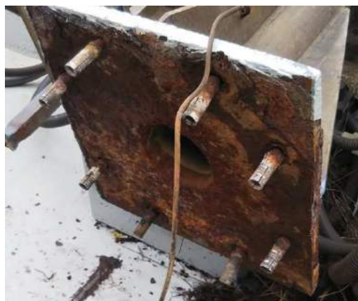
【8本全てが抜けたアンカーボルト】
