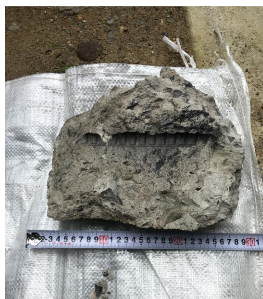
写真2 剥落したコンクリート片
