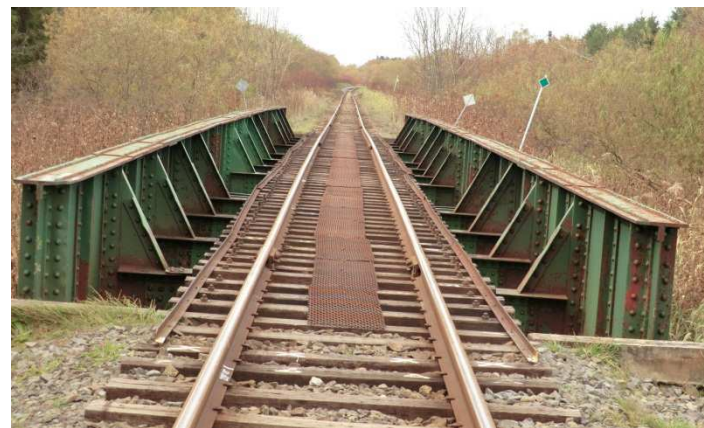
■ サロベツ川第1避溢橋りょう : 大正15(1925)年～ (宗谷線 徳満・兜沼間)
