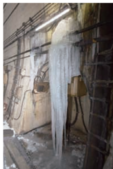
漏水が凍ってできた氷結
