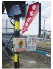
万が一のとき、列車の運転士に異常を知らせる踏切の非常ボタン
