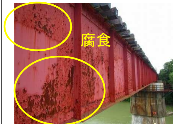
腐食が発生した橋りょう
