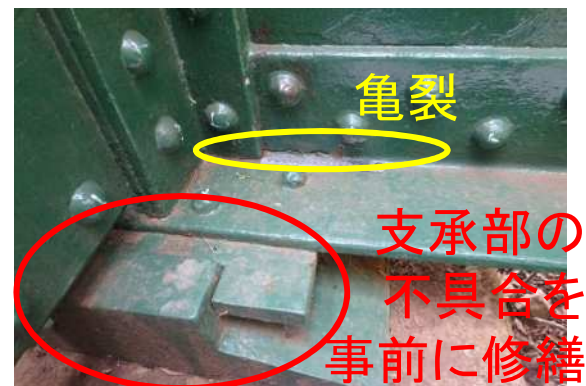
亀裂が発生した橋りょう
