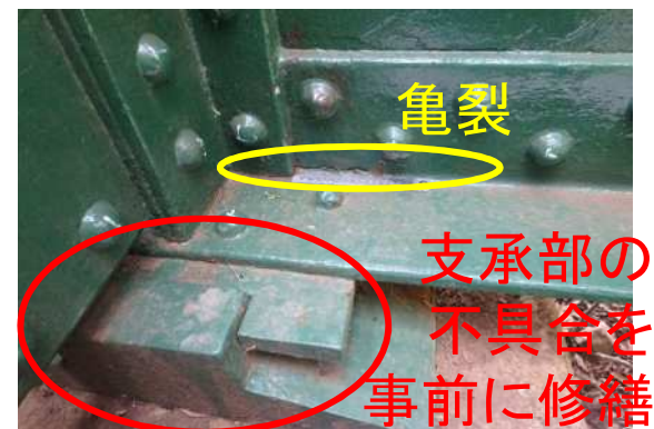
亀裂が発生した橋りょう
