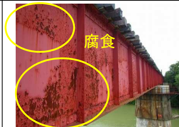
腐食が発生した橋りょう
