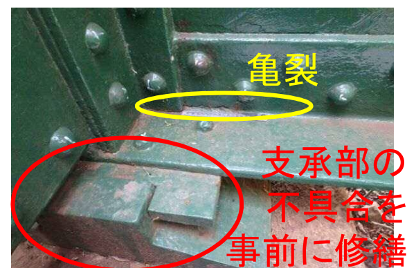
亀裂が発生した橋りょう
