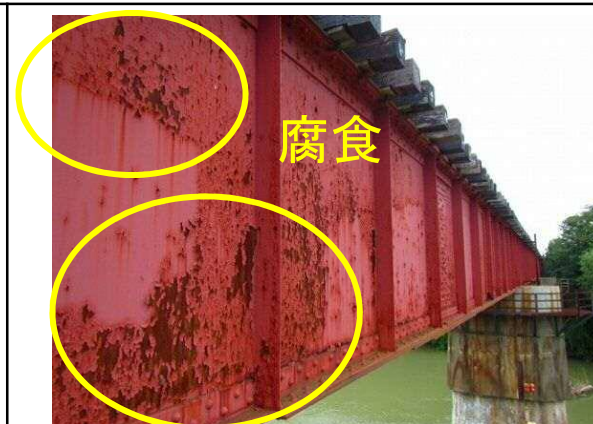
腐食が発生した橋りょう
