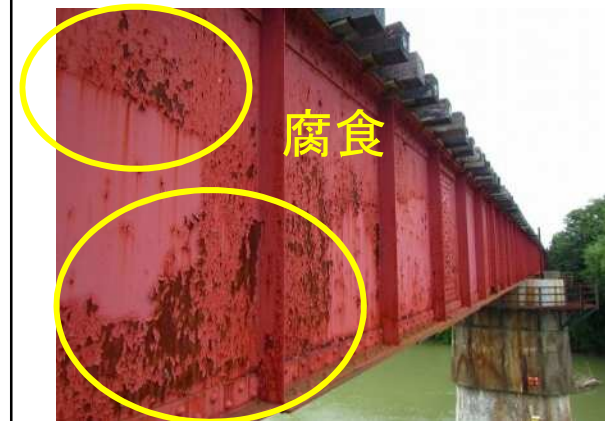
腐食が発生した橋りょう
