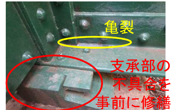
亀裂が発生した橋りょう
