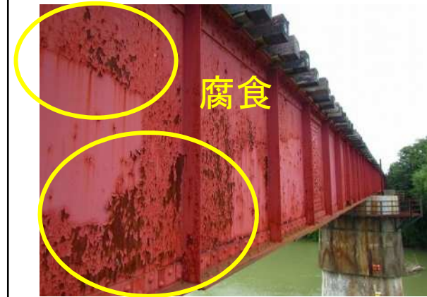
腐食が発生した橋りょう
