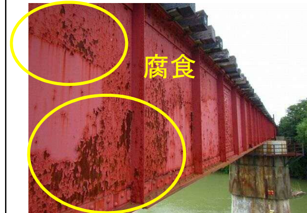
腐食が発生した橋りょう
