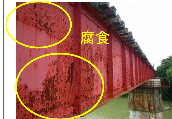
腐食が発生した橋りょう
