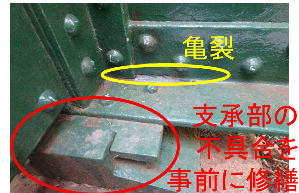
亀裂が発生した橋りょう
