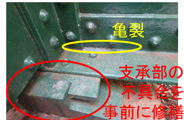
亀裂が発生した橋りょう
