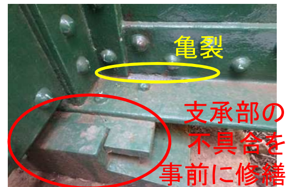
亀裂が発生した橋りょう
