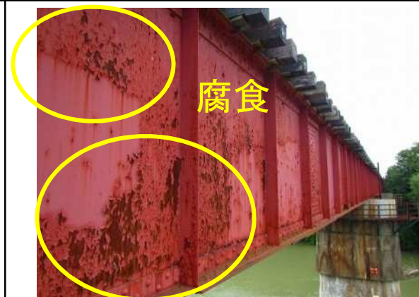
腐食が発生した橋りょう
