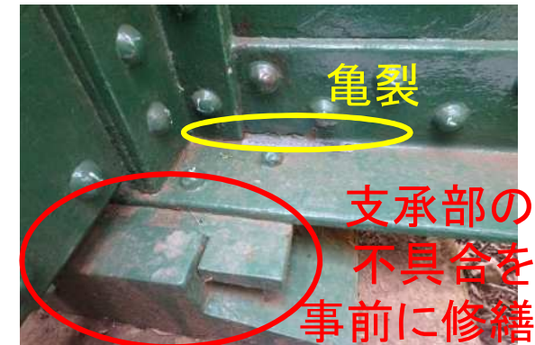
亀裂が発生した橋りょう
