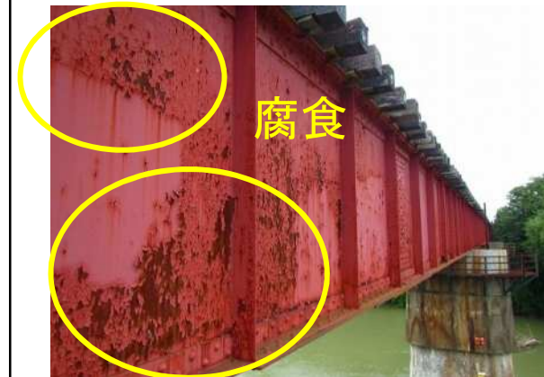
腐食が発生した橋りょう
