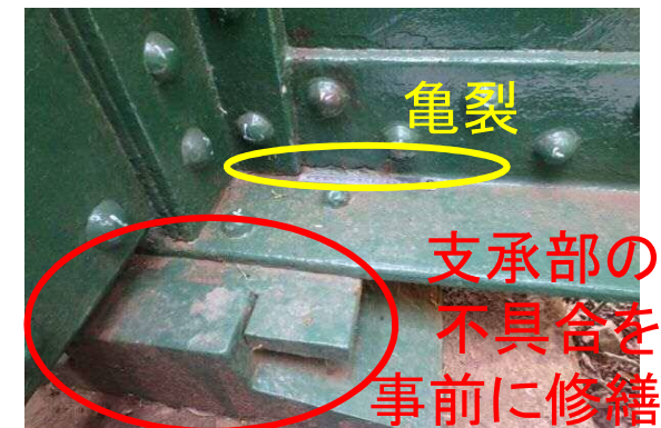
亀裂が発生した橋りょう
