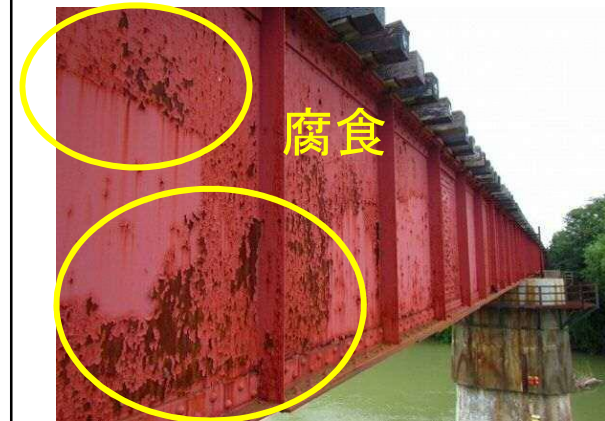
腐食が発生した橋りょう
