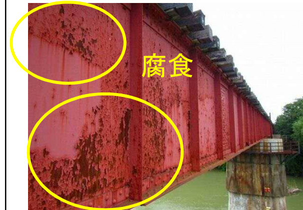
腐食が発生した橋りょう
