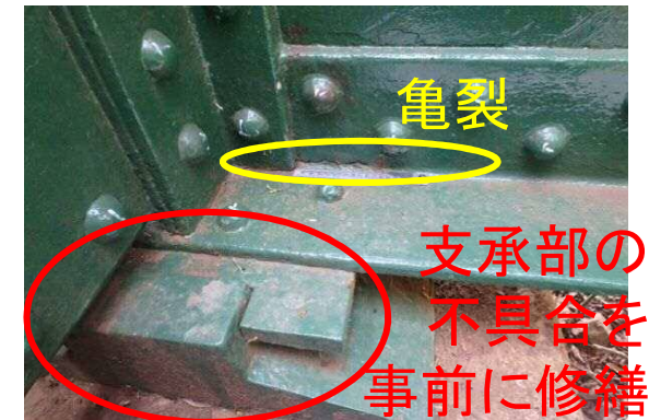
亀裂が発生した橋りょう
