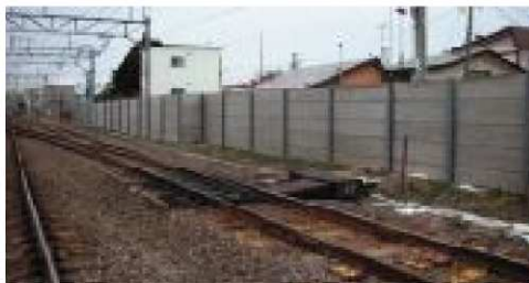
江差線沿線に設置した防音壁
