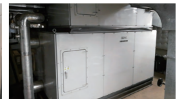
外気処理空調機
