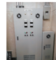
インバータ制御盤
