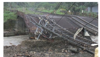
根室線新得駅構内 橋りょう流失(2016(平成28)年8月)
